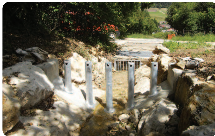
Installation d'un piège à gravier le long du ruisseau du Petit Pré.
