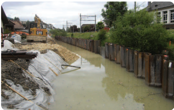
Intempéries en juin 2016 : le chantier est sous l'eau.
